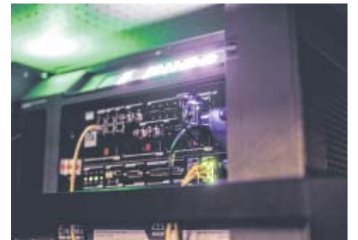
In der „Kino-Feuerwehr“ ist modernstes Equipment eingebaut.
